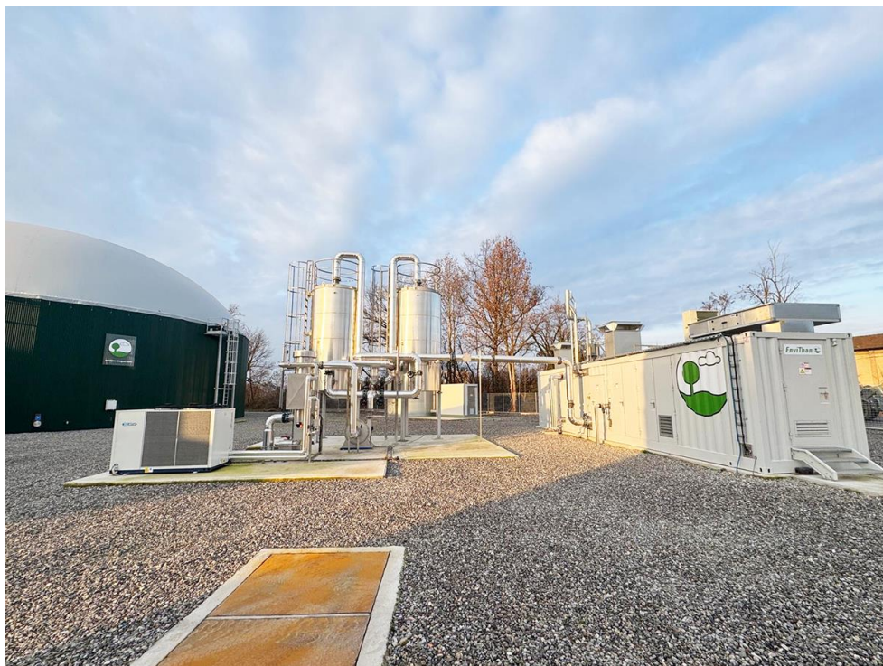
Il nuovo impianto di biogas e upgrading del gas di Azienda Avogadri immette biometano nella rete pubblica del gas. (Foto: EnviTec Biogas AG)
